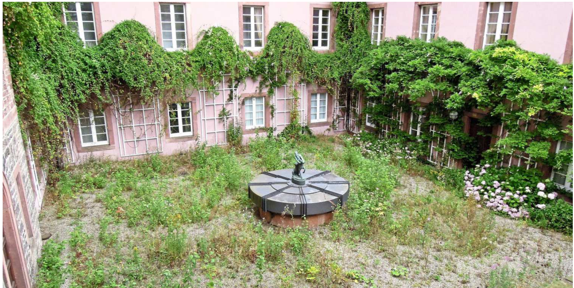
Im Innenhof wächst das Gras: Das denkmalgeschützte Schlosshotel Bühlerhöhe an der Schwarzwaldhochstraße steht seit inzwischen zwölf Jahren leer. Der Sanierungsbedarf des Kulturdenkmals ist mittlerweile massiv. Foto: Ulrich Coenen
