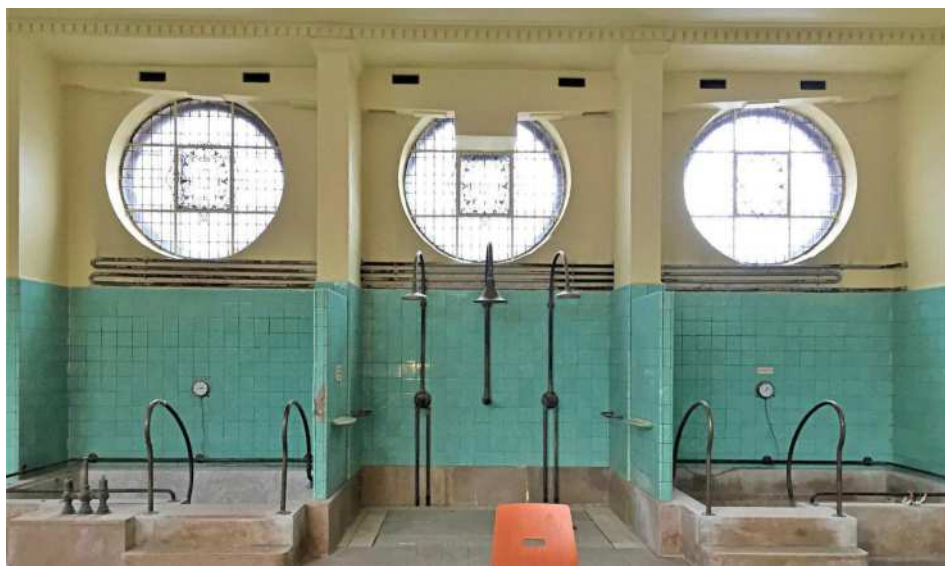
Großer Sanierungsbedarf: Das historische Stadtbad in der Elsassmetropole ist seit 2018 geschlossen.
